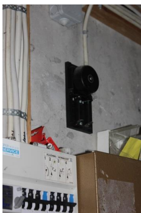
Gruppetavle med fejlstrømsrelæ i sekundær varmecentral i kælder (Lærkehegnet 22-40). Den sorte alarm på væg er koblet til drænpumpe, men er ikke i drift.
