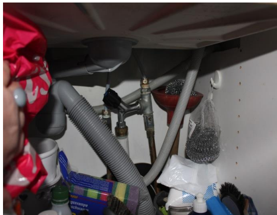
Vandrør ført i kobber i lejlighed.
