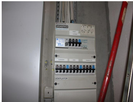
Gruppetavle med fejlstrømsrelæ ifm. fælleslokale i kælder.
