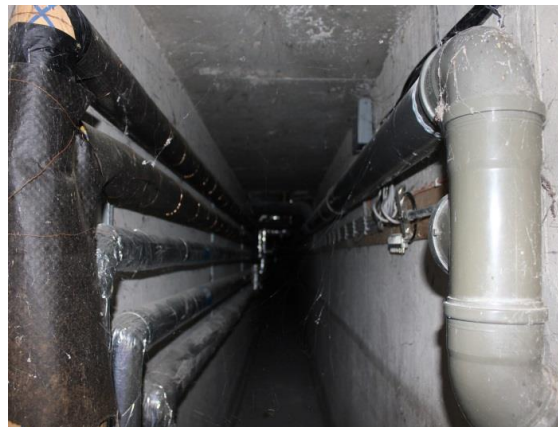
Afløbsledning ført langs væg i ingeniørgang under bygning (Lærkehegnet 42-60).
