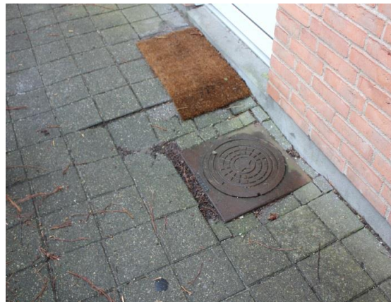
Regn- eller drænbrønd placeret langs facade.
