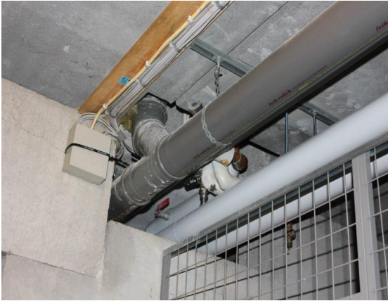
Afløbsledning ført under loft i kælder.
