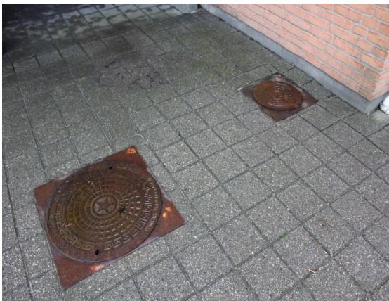
Regn- eller drænbrønd placeret langs facade. Meterbrønd, vurderes at være til sort spildevand.
