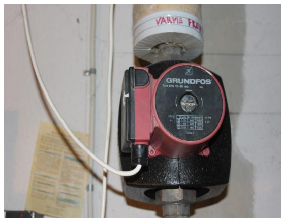
Cirkulationspumpe (Grundfos) i primære varmecentral.
