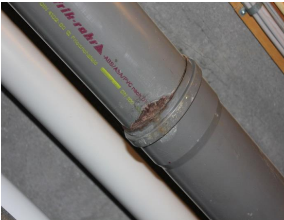
Afløbsledning ført under loft i kælder. Der ses tegn på begyndende utæthed i rørsamling.
