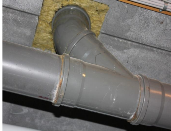
Afløbsledning ført under loft i kælder.
