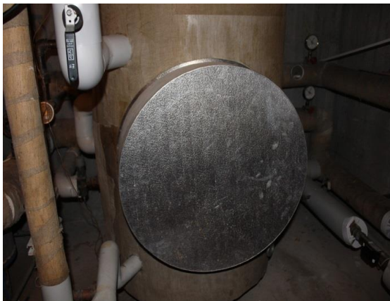
Varmtvandsbeholder i primære varmecentral (Lærkehegnet nr. 201-249).
