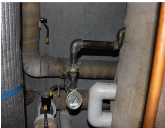
Varmtvandsbeholder, rørføringer, termometer i primære varmecentral.
