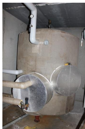
Varmtvandsbeholder i sekundære varmecentral (Lærkehegnet nr. 22-40).
