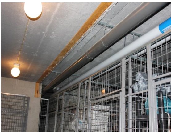
Afløbsledninger og el-kabler, ført under loft i kælder.
