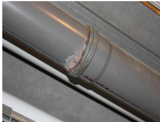
Afløbsledninger ført under loft i kælder. Der ses tegn på begyndende utæthed i rørsamling.
