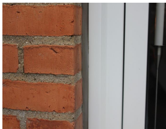
Vinduesfuger fremstår generelt i god stand.
