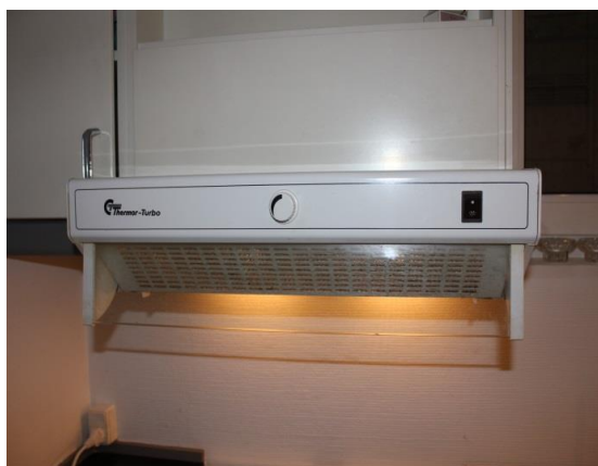
Emhætte i køkken i forbindelse med fælleslokale i kælder.
