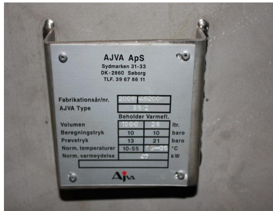
Skilt på varmtvandsbeholder i primære varmecentral (år 2006 / 1.000 liter).
