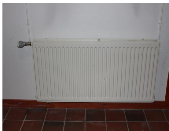
Kælderrum er opvarmet med radiatorer.
