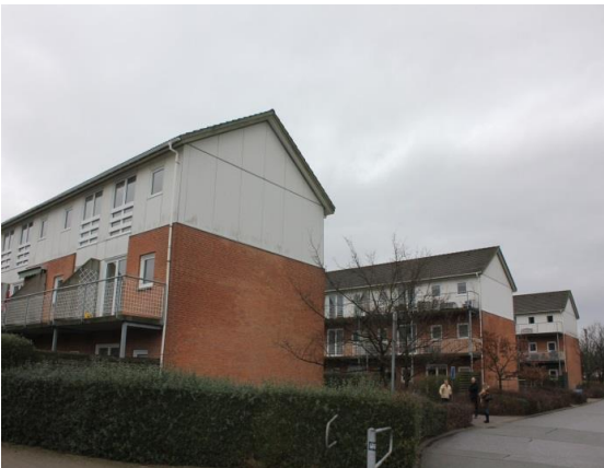
Gavle vendt mod vest. Overfacader / -gavle fremstår beklædt med plader af fibercement.
